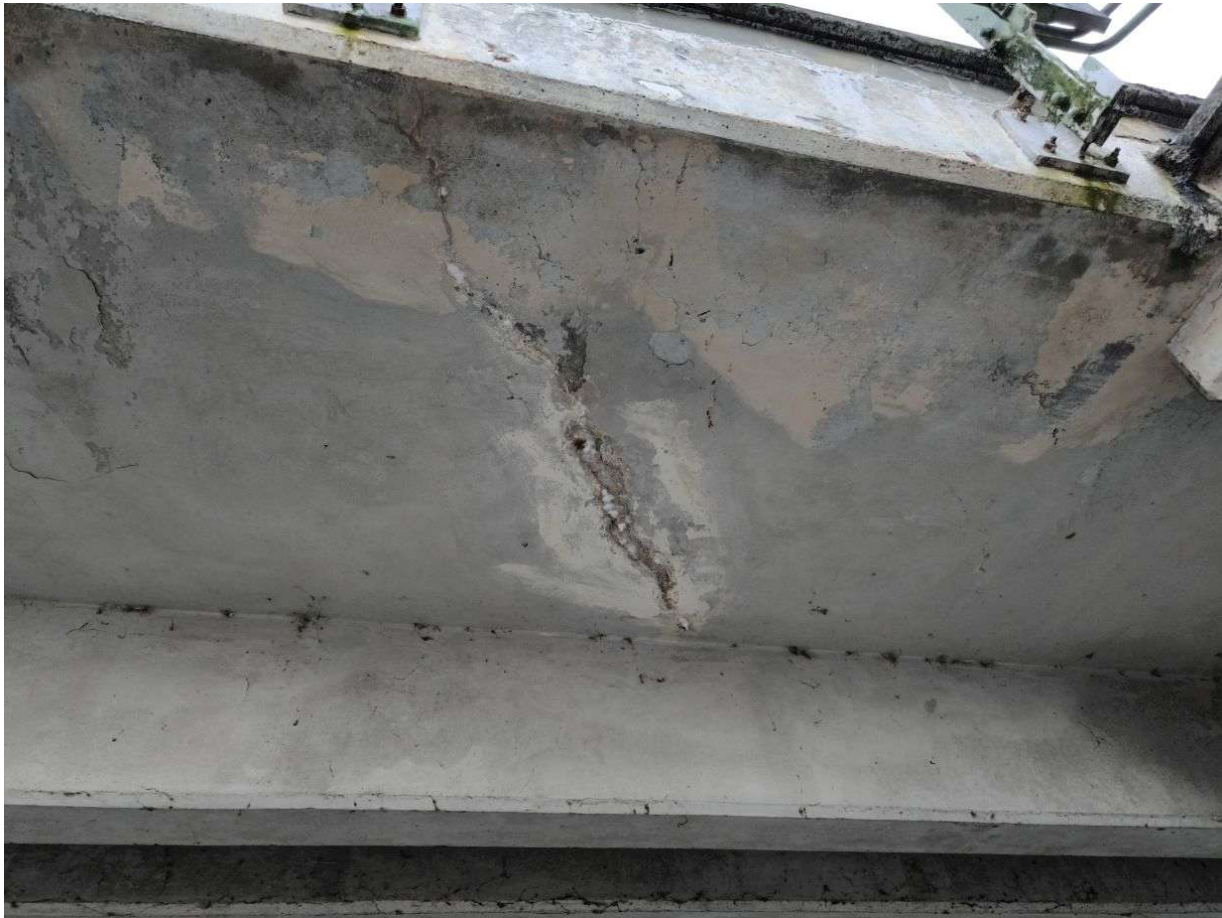
Bild 7: Riss an der Podestunterseite
